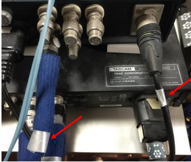
クロックリベラメンテ GPS-777 クロック出力側 (矢印左側) GPS-777 アンテナ線直貼り (矢印右側)
