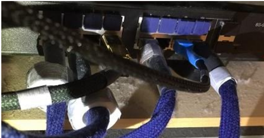
対策後のスイッチングハブと LAN ケーブル
